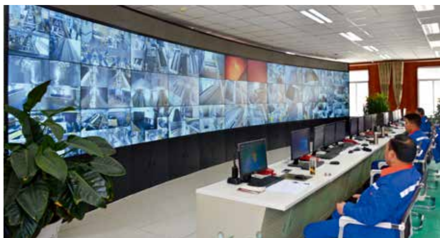
祁连山水泥生产调度系统
