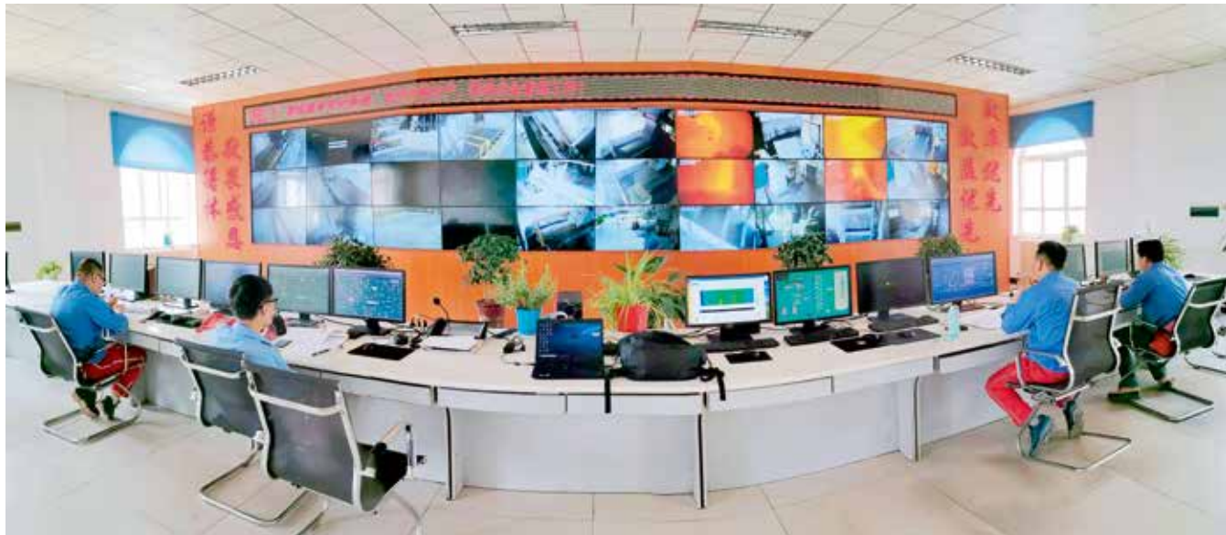
太阳山生产区中控室
